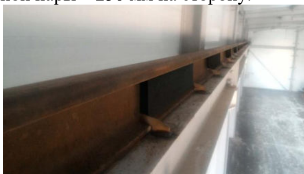
Рис. 22. Система вибропоглощения рельсов мостового крана
